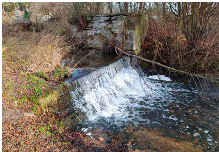
Fot. 1. Próg na Wirynce – stara, częściowo zniszczona konstrukcja o wysokości < 2 m (fot. Tomasz Jabłoński).
